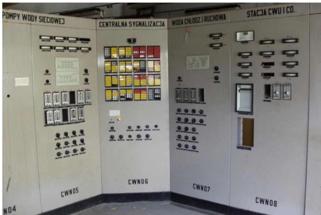
Fot. 12 Budynek PWS - widok wnętrza – segment środkowy – kondygnacja górna – nastawnia
