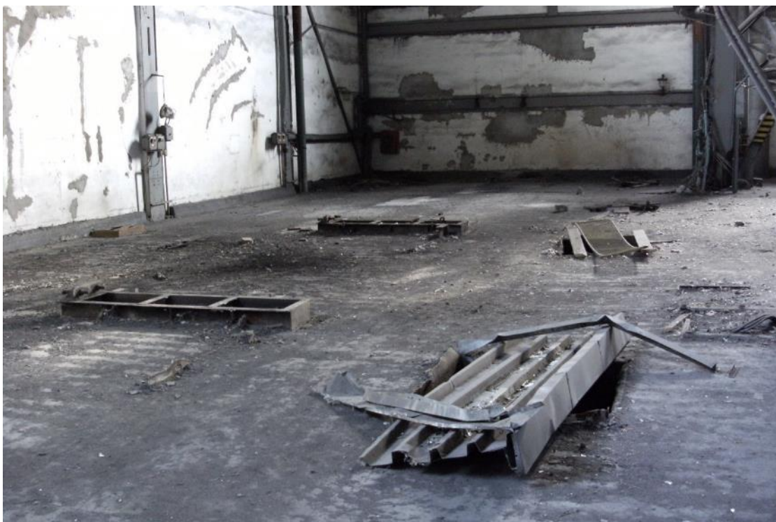
Fot. 52 Budynek BGK – widok wnętrza I piętra – otwory technologiczne w stropie bez zabezpieczenia
