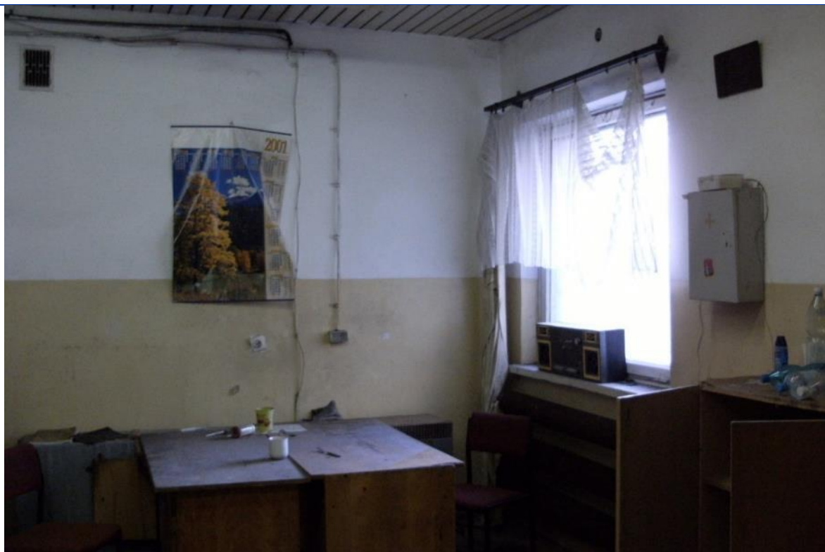
Fot. 32 Budynek BRiNO - widok wnętrza – piętro pomieszczenie sterownicze
