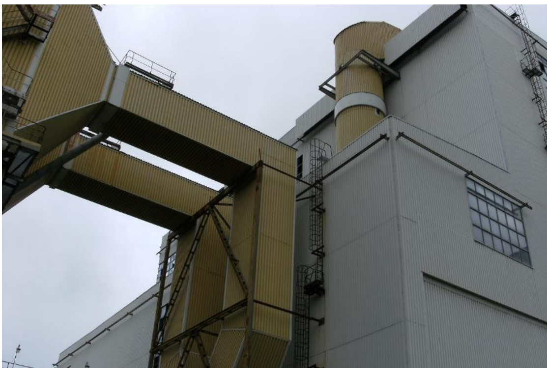
Fot. 131 Filtr oczyszczania spalin - widok na kanały doprowadzające do filtra
