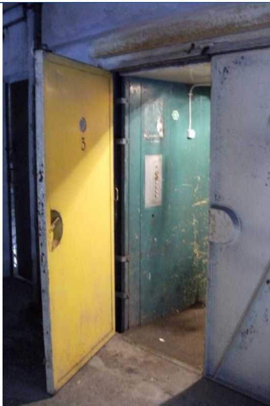
Fot. 47 Budynek BGK – widok wnętrza – dźwig osobowo-towarowy
