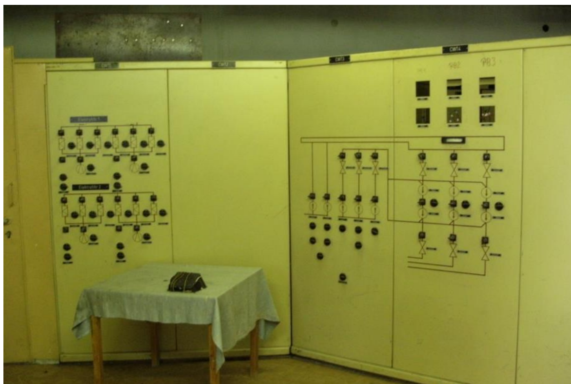
Fot. 31 Budynek BRiNO - widok wnętrza – piętro pomieszczenie z szafami sterowniczymi
