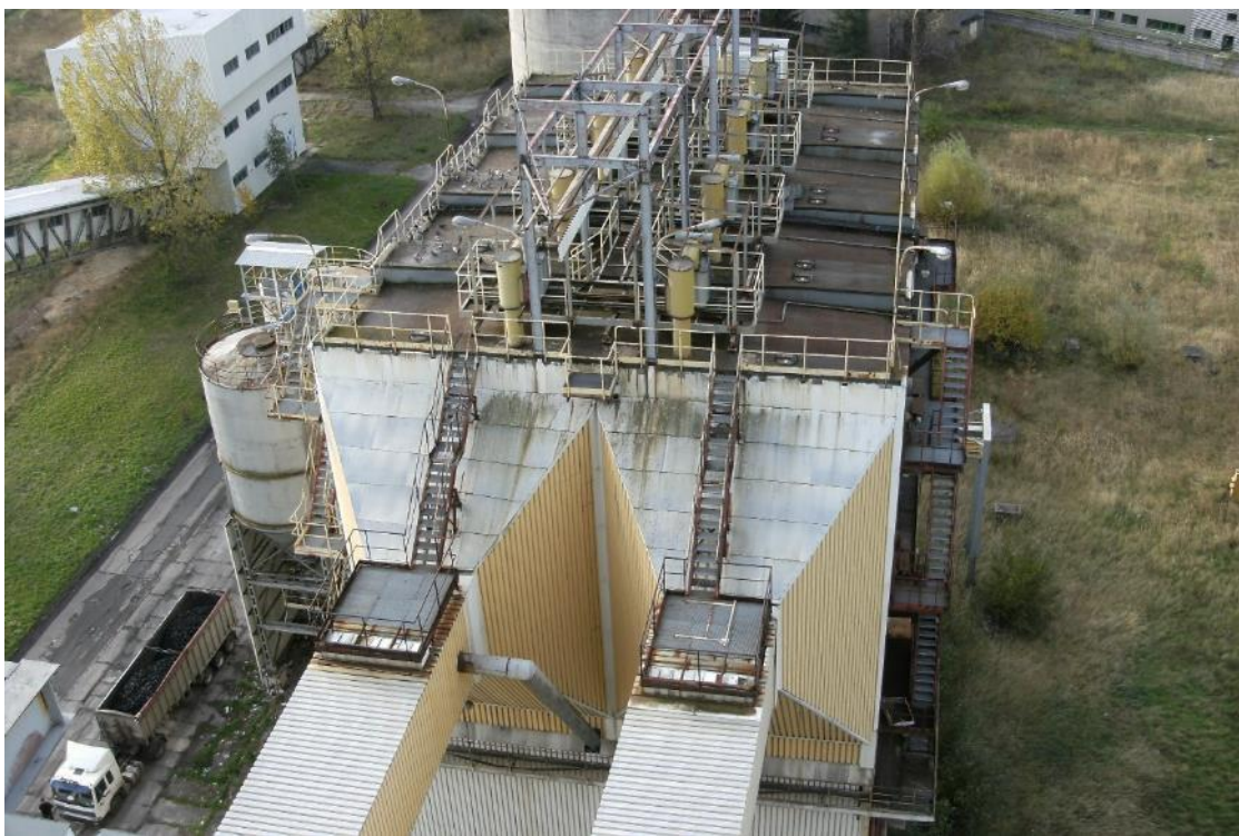
Fot. 124 Filtr oczyszczania spalin
