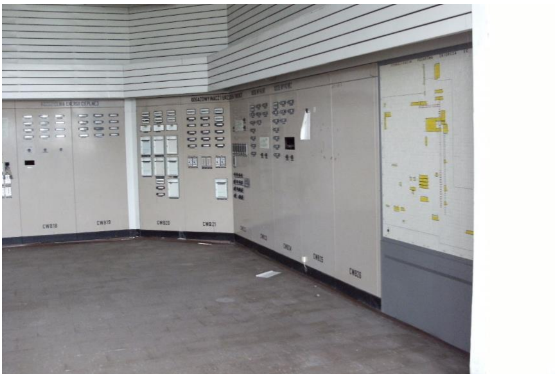
Fot. 84 Budynek DCE – widok wnętrza dyspozytorni
