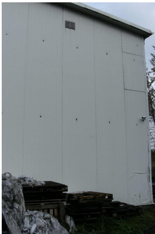
Fot. 148 Budynek magazynowy – elewacja zachodnia z widocznym zdeformowanym panelem narożnym.
