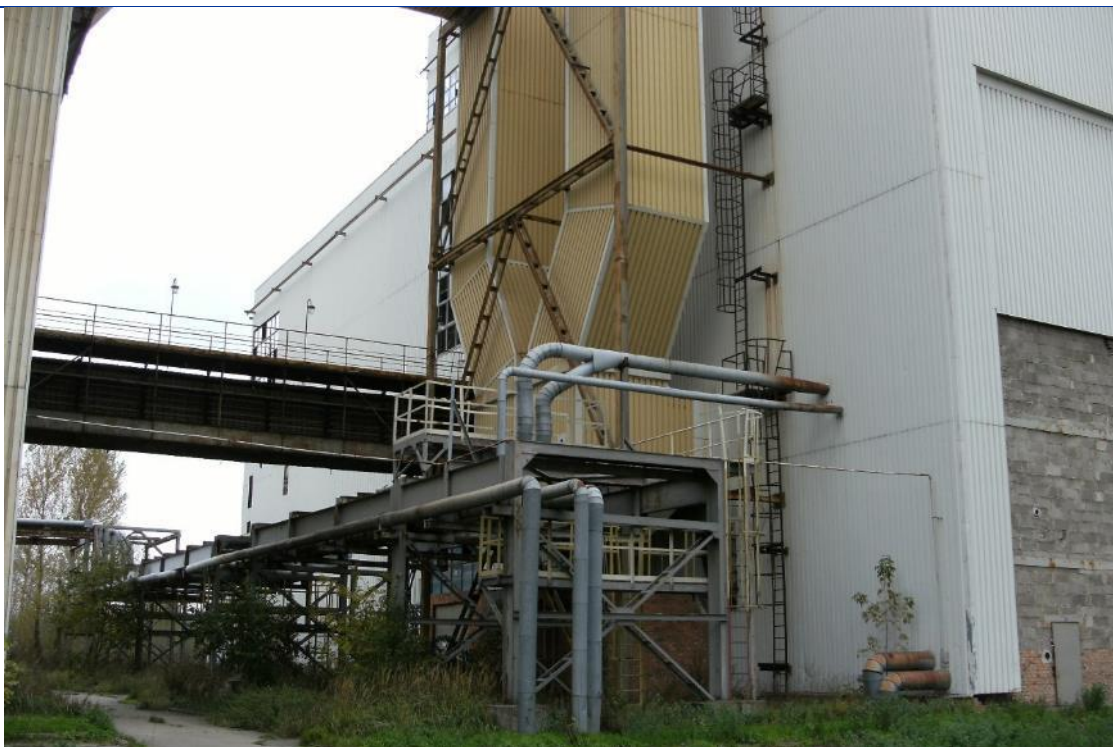
Fot. 132 Filtr oczyszczania spalin - widok na kanały doprowadzające do filtra od strony północnej
