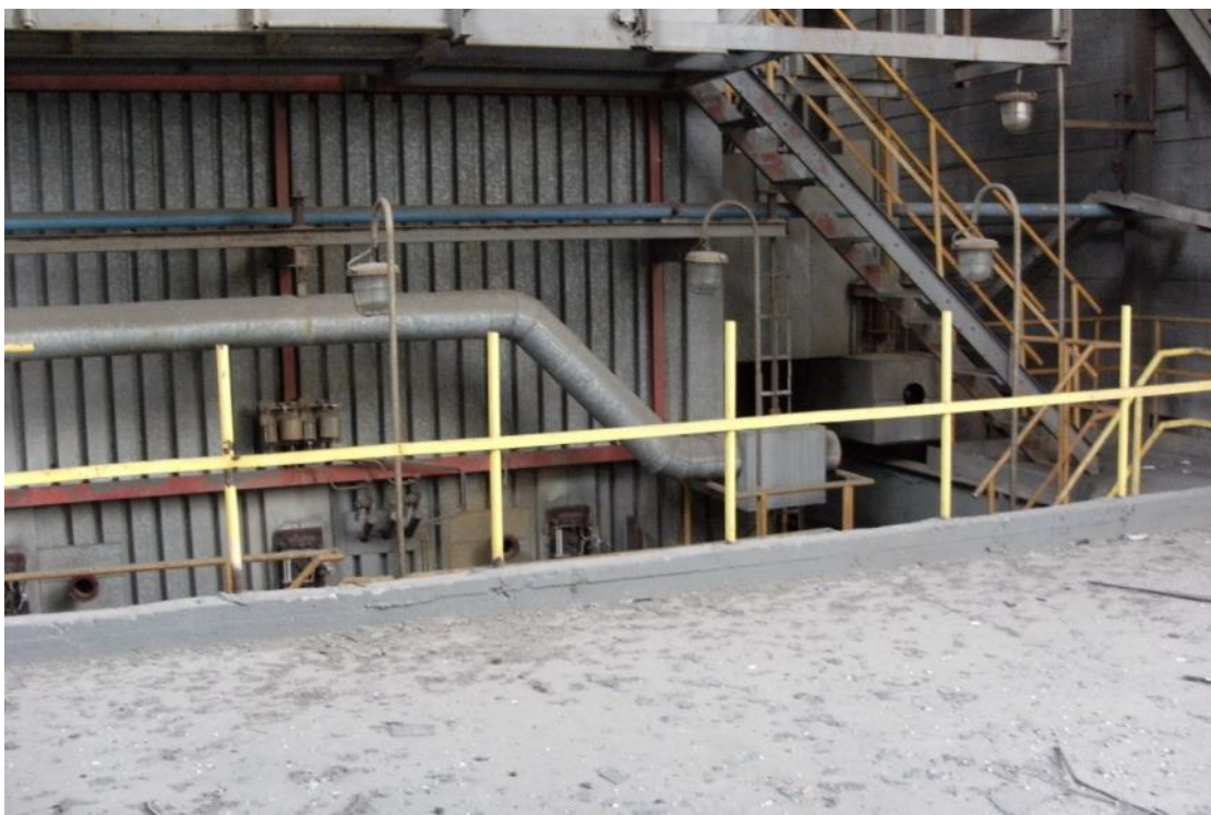
Fot. 51 Budynek BGK – widok wnętrza II piętra na kocioł
