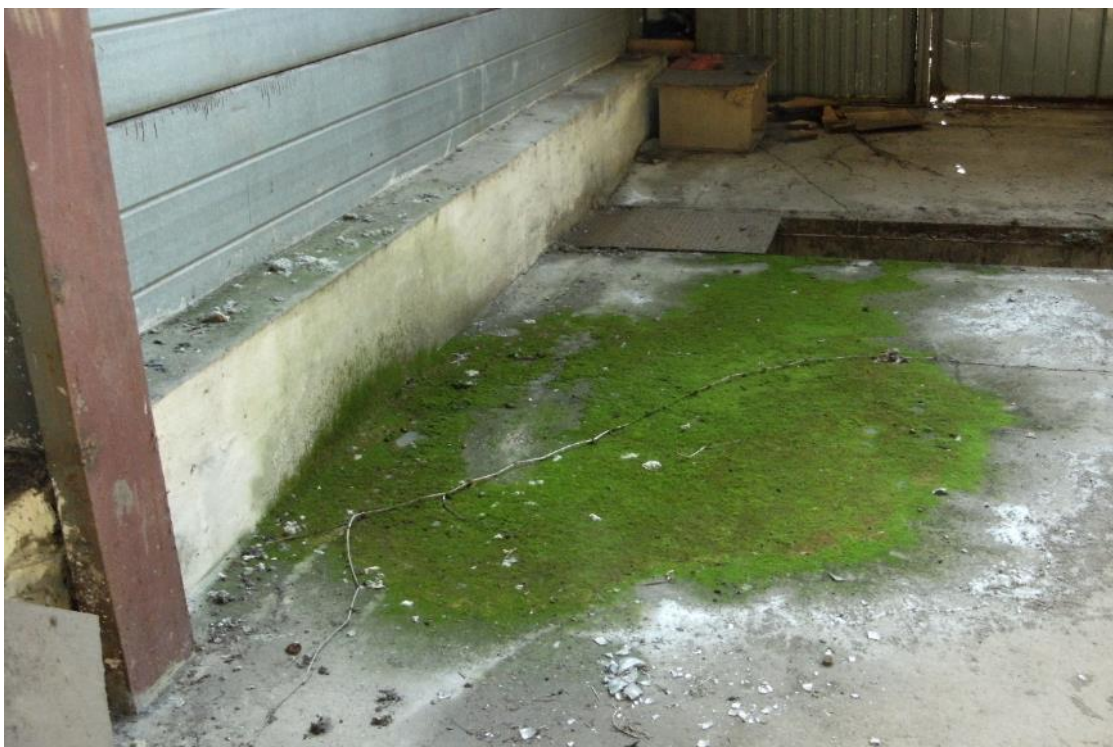
Fot. 11 Budynek PWS - widok wnętrza – segment lewy - pompownia kondygnacja dolna lokalna degradacja posadzki
