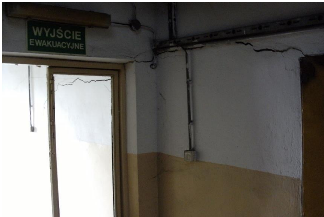
Fot. 30 Budynek BRiNO - widok wnętrza – spękania ściany w korytarzu na parterze
