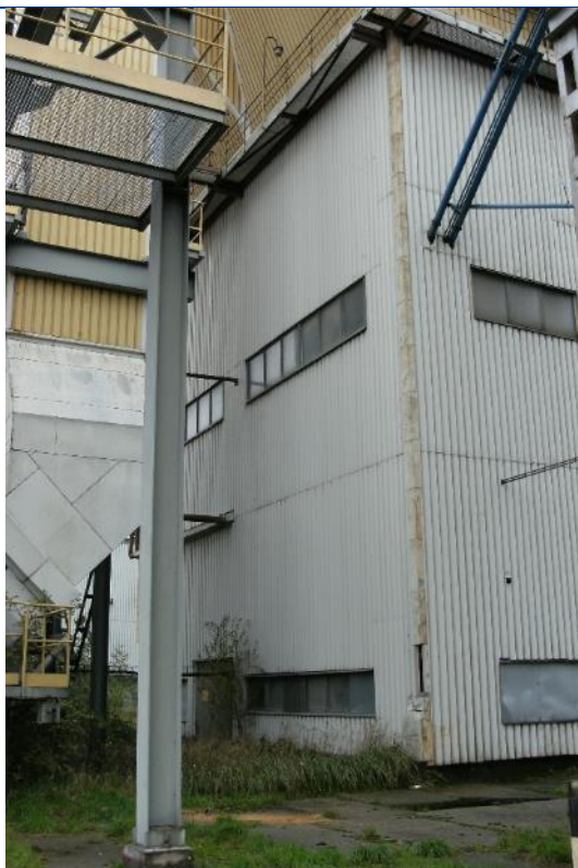
Fot. 130 Filtr oczyszczania spalin - widok na elewację południową filtra
