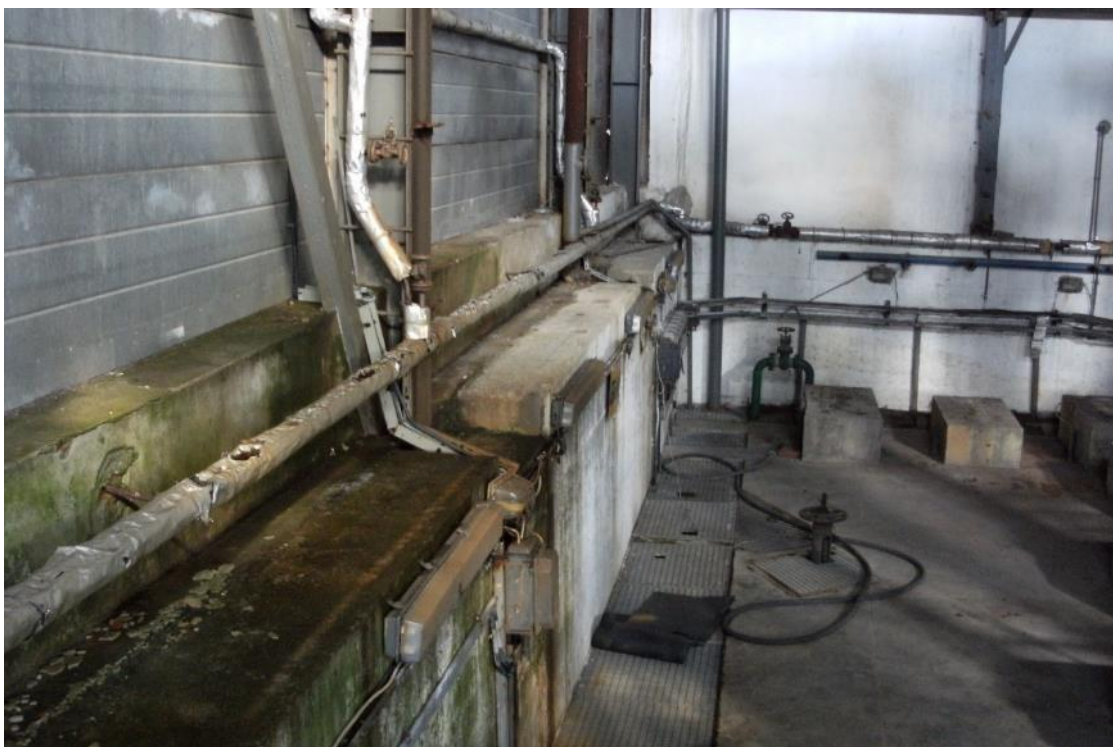
Fot. 22 Budynek PB – widok wnętrza – korozja ścian żelbetowych
