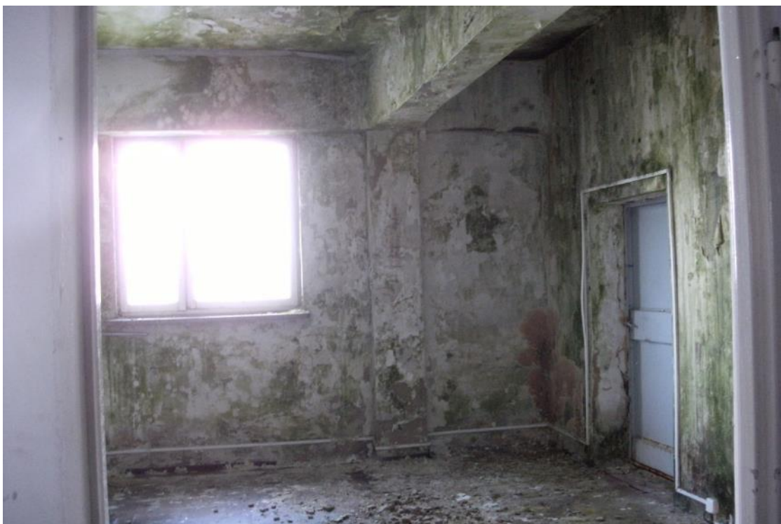
Fot. 76 Budynek BUT – widok wnętrza na zagrzybione pomieszczenie
