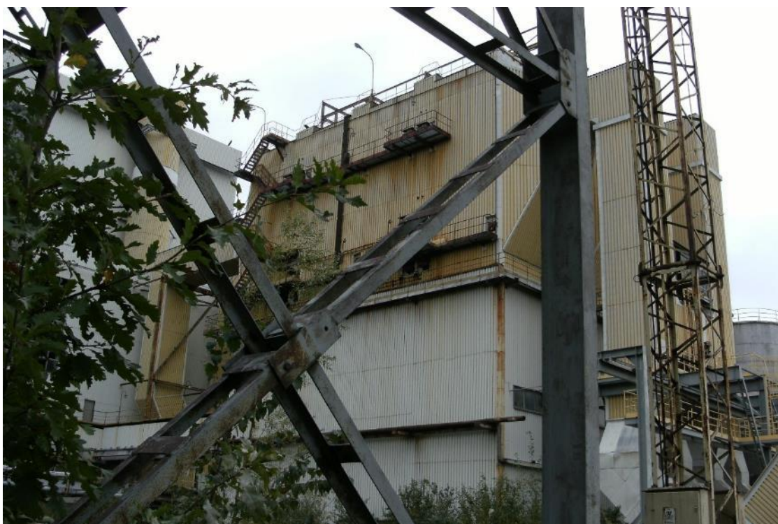
Fot. 133 Filtr oczyszczania spalin - widok na elewację zachodnią filtra
