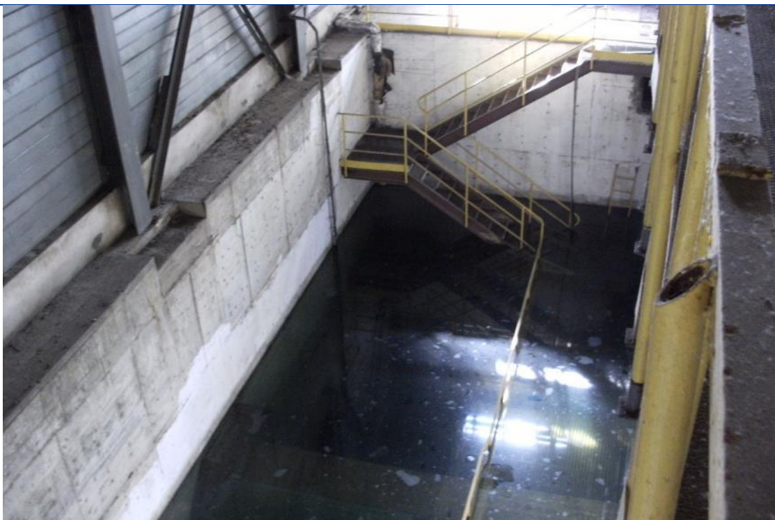
Fot. 19 Budynek PB – widok wnętrza – zalana część podziemna budynku
