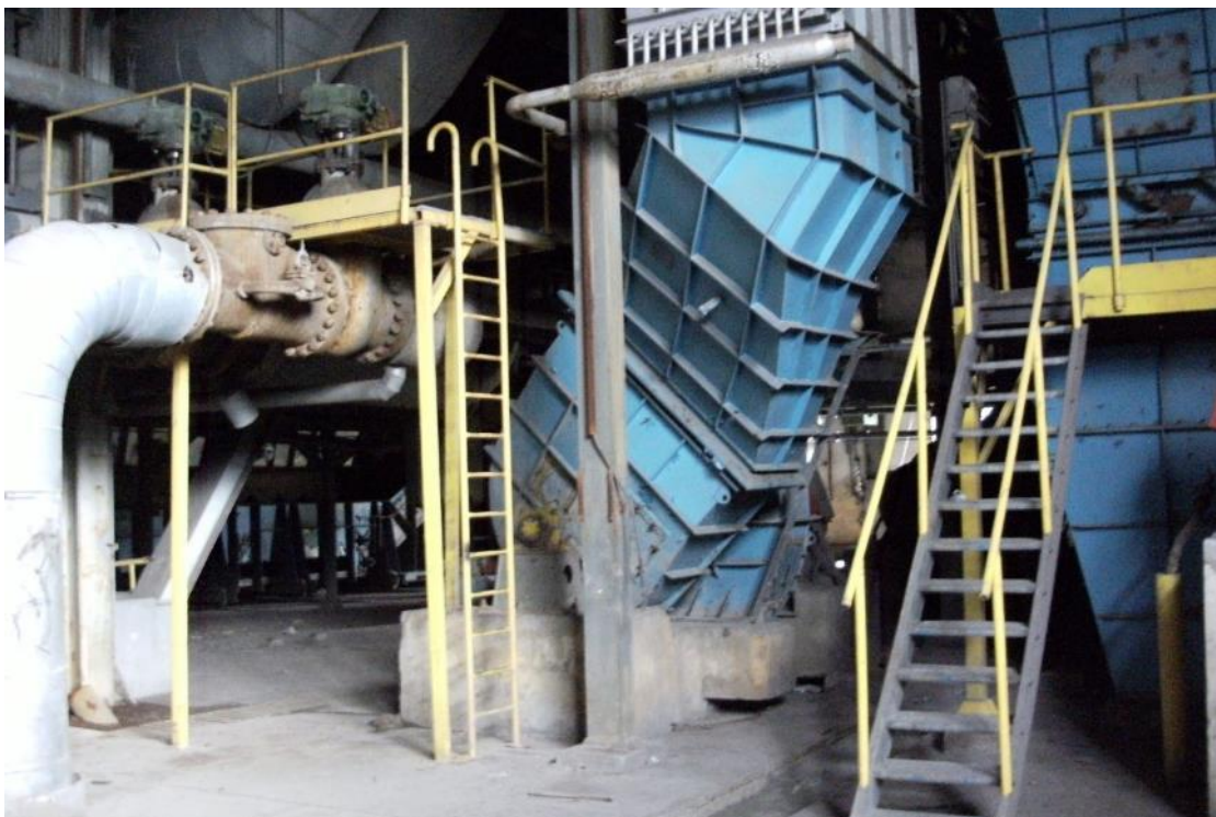
Fot. 56 Budynek BGK – widok wnętrza parteru na konstrukcje wsporcze urządzeń
