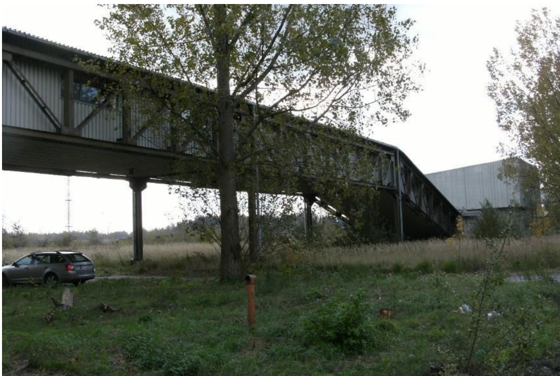
Fot. 111 Przenośnik węgla – widok na most nr 3
