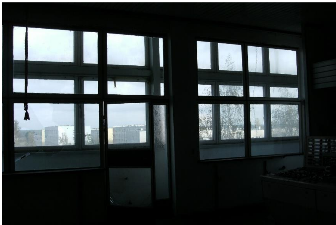
Fot. 63 Budynek BRiNK – widok wnętrza – pomieszczenie nastawni kotła
