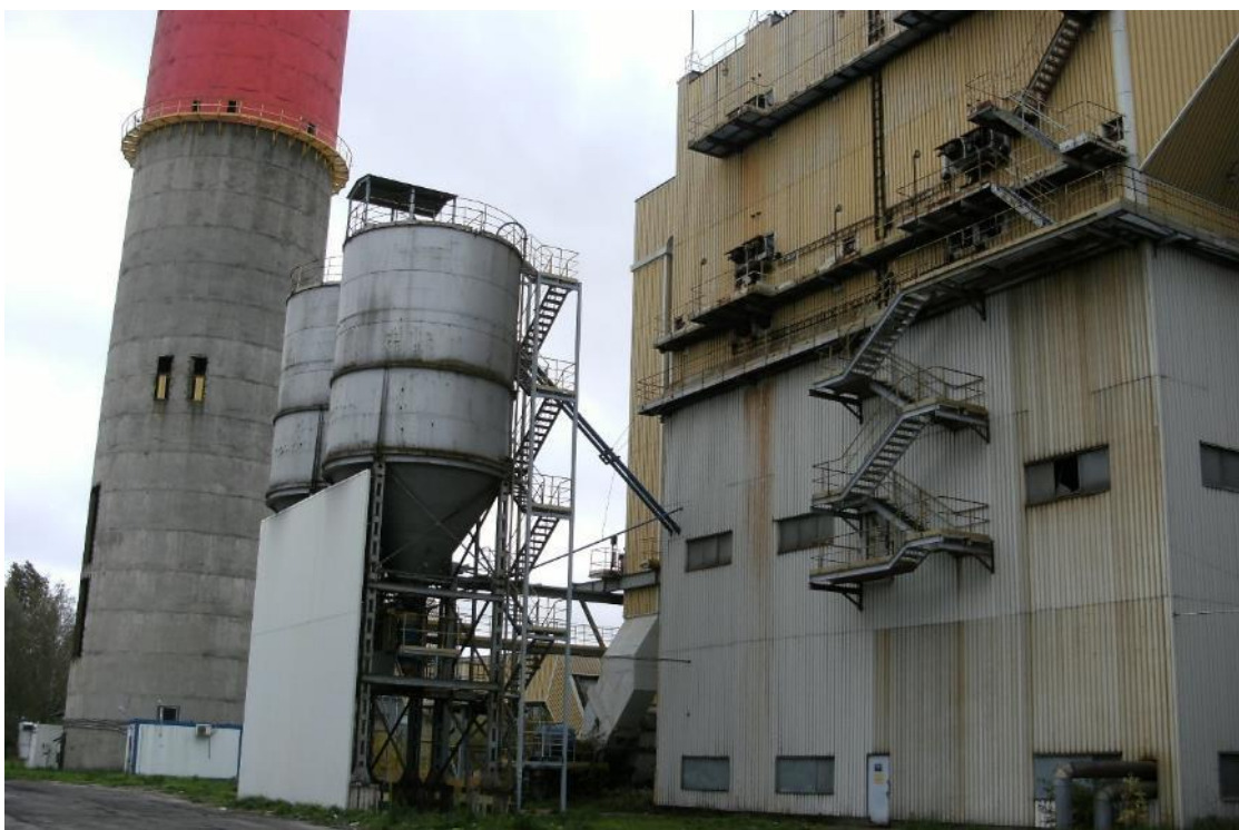
Fot. 126 Filtr oczyszczania spalin - widok na elewację wschodnią filtra
