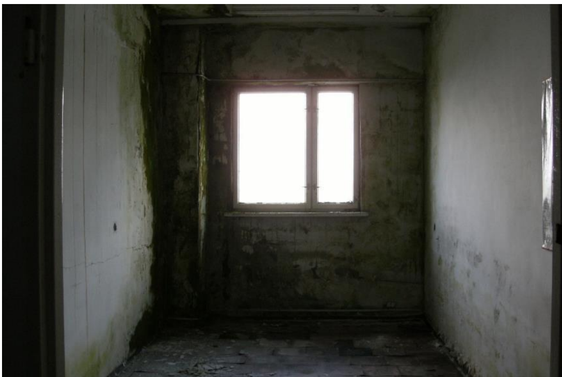
Fot. 75 Budynek BUT – widok wnętrza zagrzybione pomieszczenie
