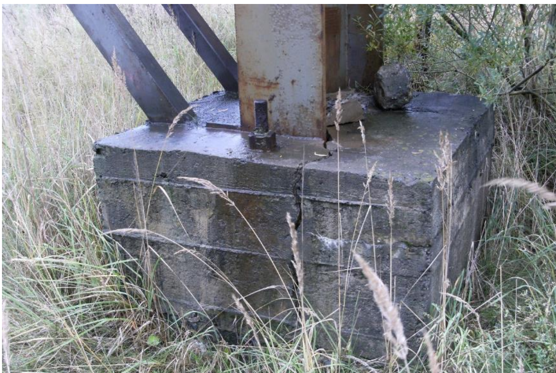
Fot. 109 Przenośnik węgla – widok na pęknięty fundament podpory pośredniej mostu nr 4
