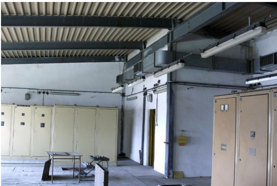
Fot. 13 Budynek PWS - widok wnętrza – segment środkowy – kondygnacja górna – rozdzielnikownia
