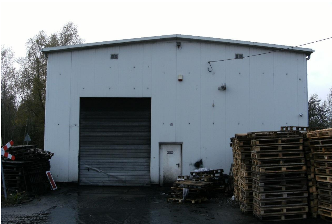
Fot. 144 Budynek magazynowy – elewacja wschodnia z widocznymi zdeformowanymi panelami bramy.
