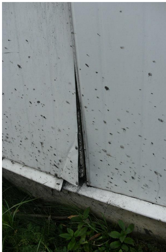
Fot. 146 Budynek magazynowy – widok na uszkodzony od wewnątrz panel ścienny.
