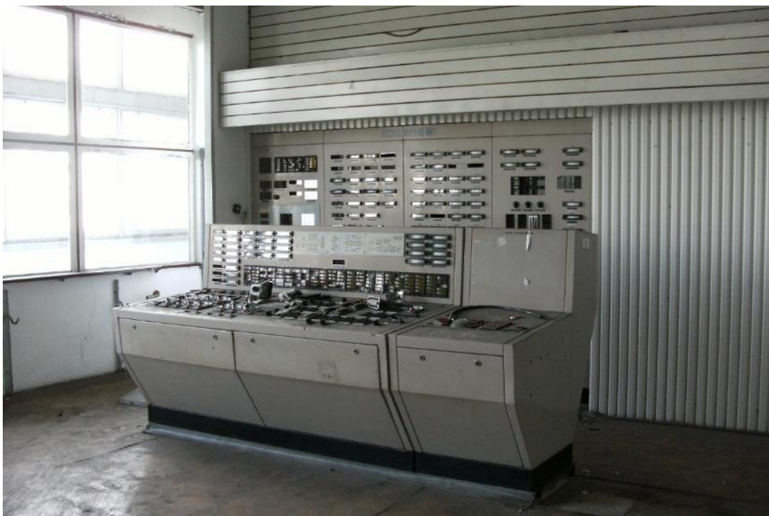
Fot. 62 Budynek BRiNK – widok wnętrza – pomieszczenie nastawni kotła
