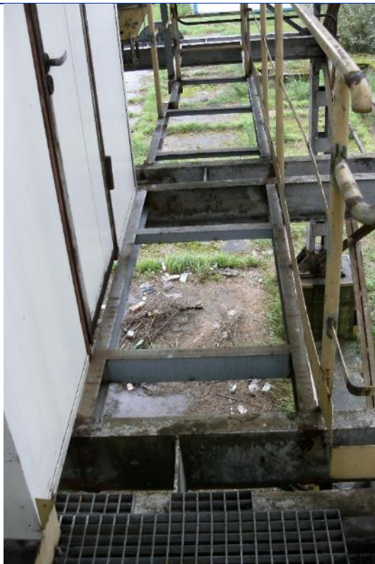
Fot. 139 Silosy – widok na brakujące podesty na poziomie 1
