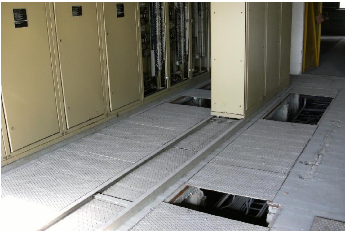
Fot. 14 Budynek PWS - widok wnętrza – segment środkowy – kondygnacja górna – rozdzielnikownia
