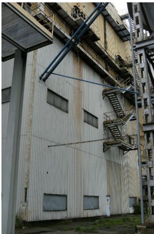
Fot. 127 Filtr oczyszczania spalin - widok na elewację wschodnią filtra
