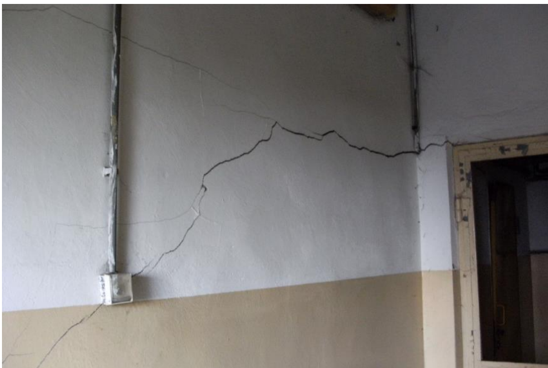
Fot. 29 Budynek BRiNO - widok wnętrza – spękania ściany w korytarzu na parterze
