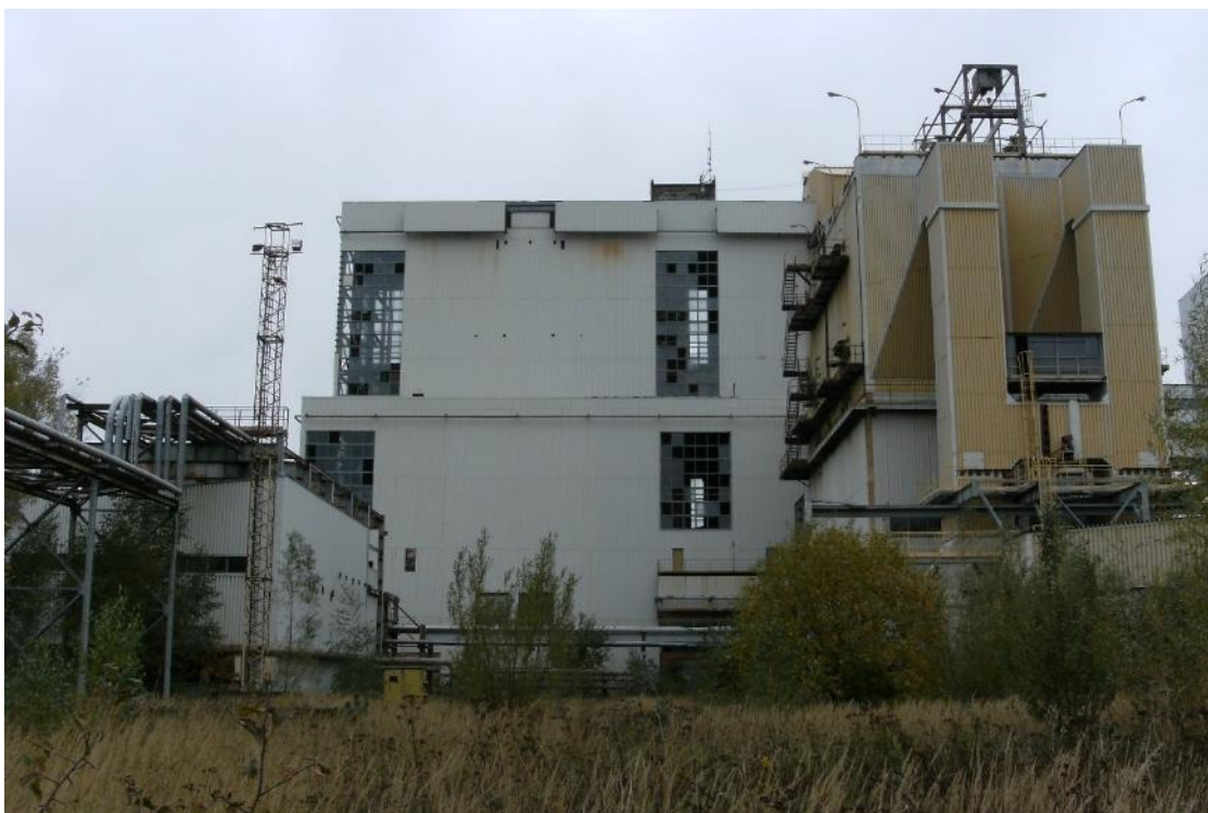
Fot. 125 Filtr oczyszczania spalin - widok na elewację południową filtra
